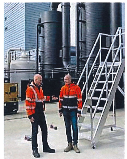
Projectmanager Antoine van Geffen en bedrijfsleider Karel Pompen bij de nieuwe geurinstallatie.
